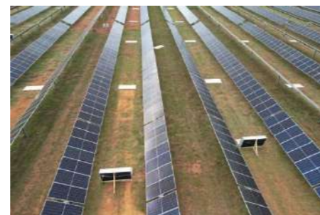
德克萨斯州项目现场 (407.7MW)
